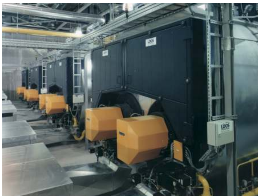
четыре двухжаротрубных газотрубных котла UNIVERSAL ZFR с паропроизводительностью 120 т/ч на бумажной фабрике
