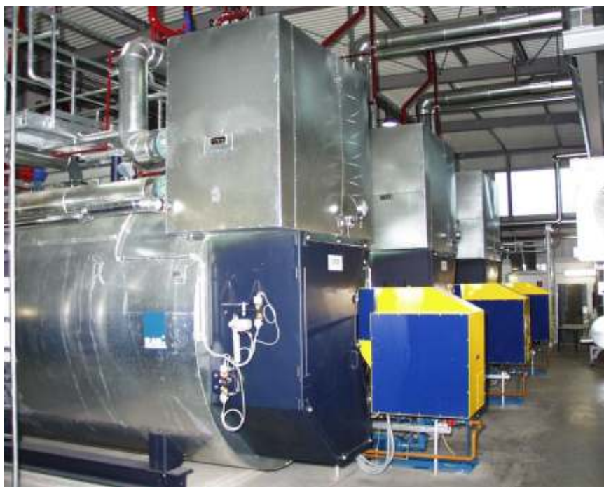
Пример применения на бумажной фабрике - 3 паровых котла с пароперегревателем.
